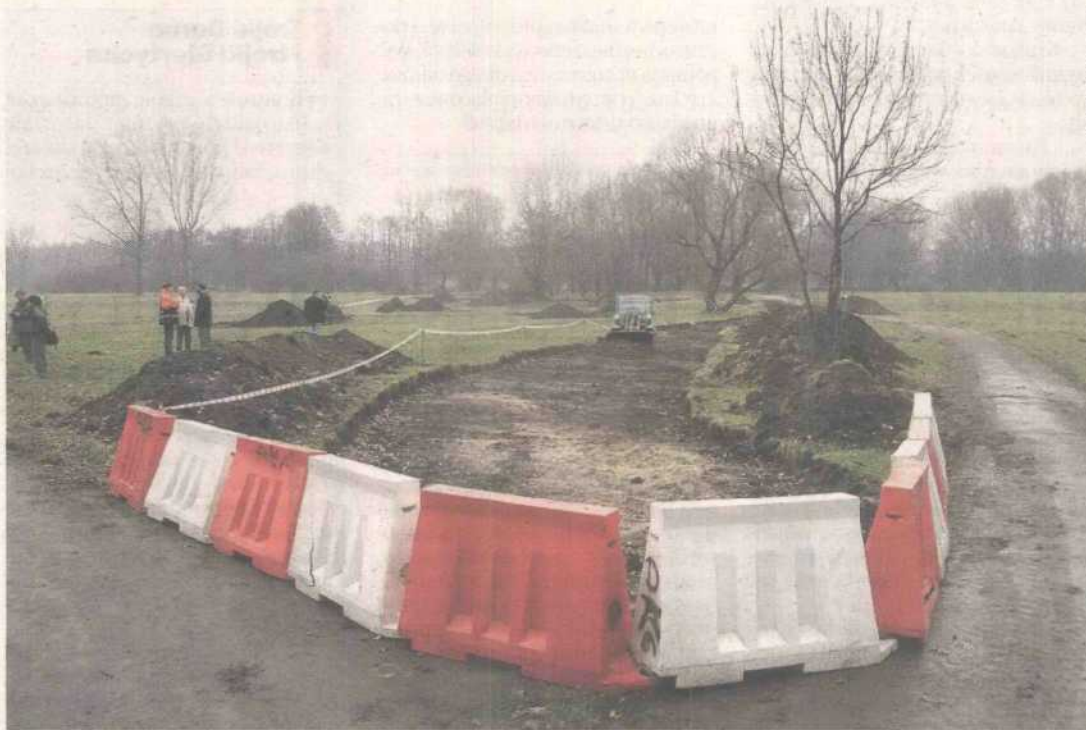
W południowo-wschodniej części parku ekipy budowlane robią już wykopy pod platformy, na których staną urządzenia
